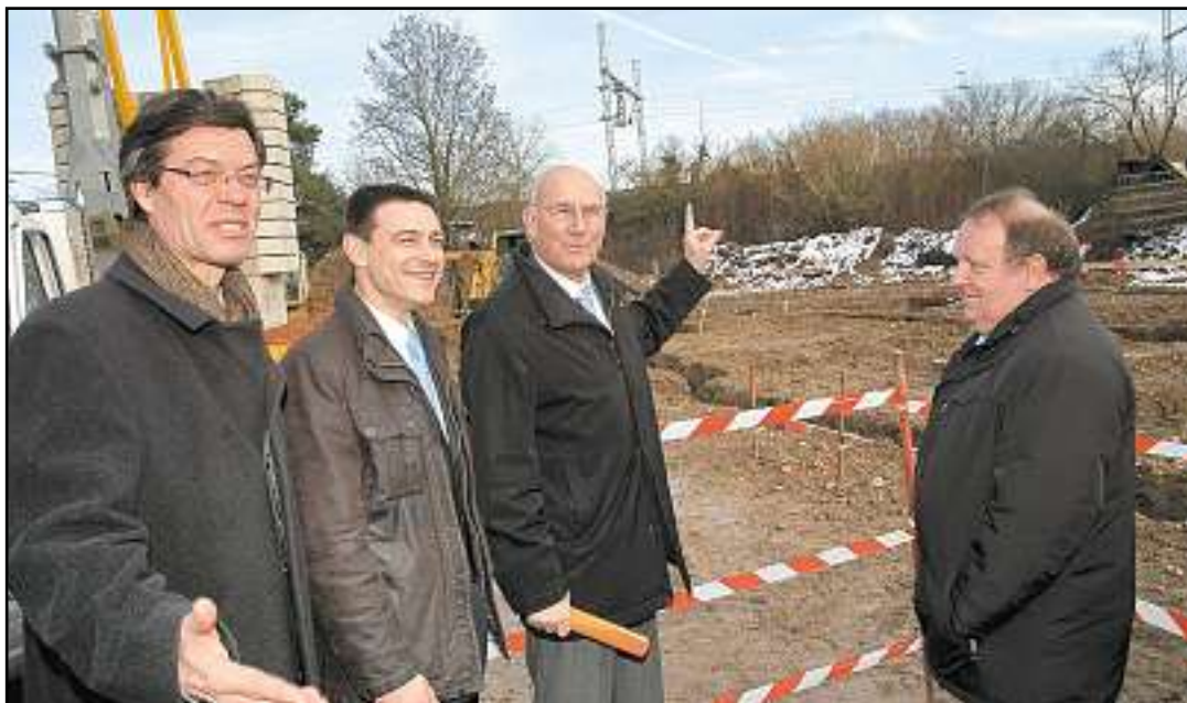
Jo Spiegel, Serge Wermelinger, Adrien Zeller et Richard Lasek devant le chantier de la future résidence économe en énergie, le Parc du Muehlmatten, à Bollwiller. Photos Bernard Biehler
